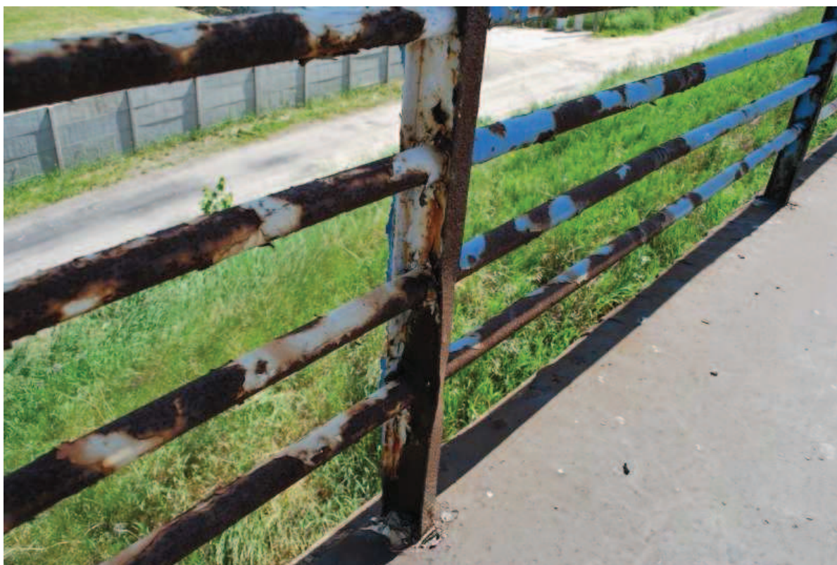
Fot. 20. Widok na słupek balustrady wschodniej. Widoczne deformacja oraz intensywna korozja stali.
