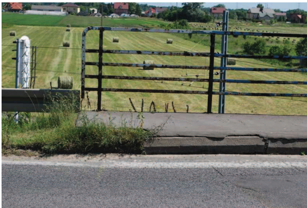
Fot. 18. Widok na chodnik wschodni od strony północnej. Widoczna wegetacja roślinności, ubytek i przemieszczenia betonu oraz ubytek nawierzchni asfaltowej chodnika. Brak prawidłowego zakończenia bariery ochronnej („baraniego rogu”) przy balustradzie.
