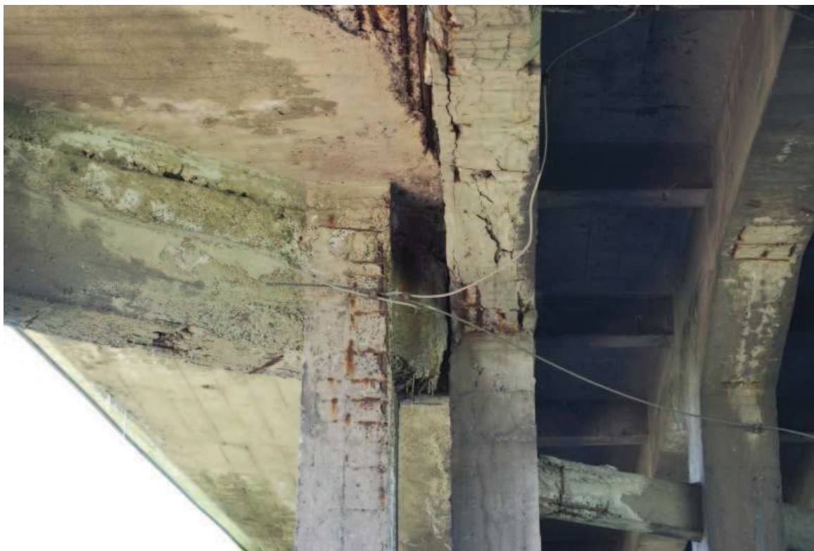
Fot. 9. Widok na północną podporę pośrednią konstrukcji od strony wschodniej. Widoczna korozja, ubytki, rysy i osady betonu oraz korozja stali zbrojeniowej spowodowane prawdopodobnie przeciekami wody przez nieszczelną izolację pomostu.
