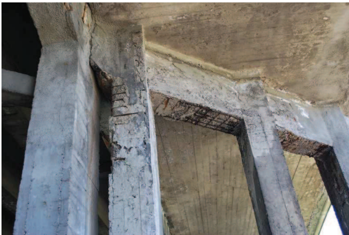
Fot. 8. Widok na południową podporę pośrednią konstrukcji od strony wschodniej. Widoczna korozja, ubytki, rysy i osady betonu oraz korozja stali zbrojeniowej spowodowane prawdopodobnie przeciekami wody przez nieszczelną izolację pomostu.
