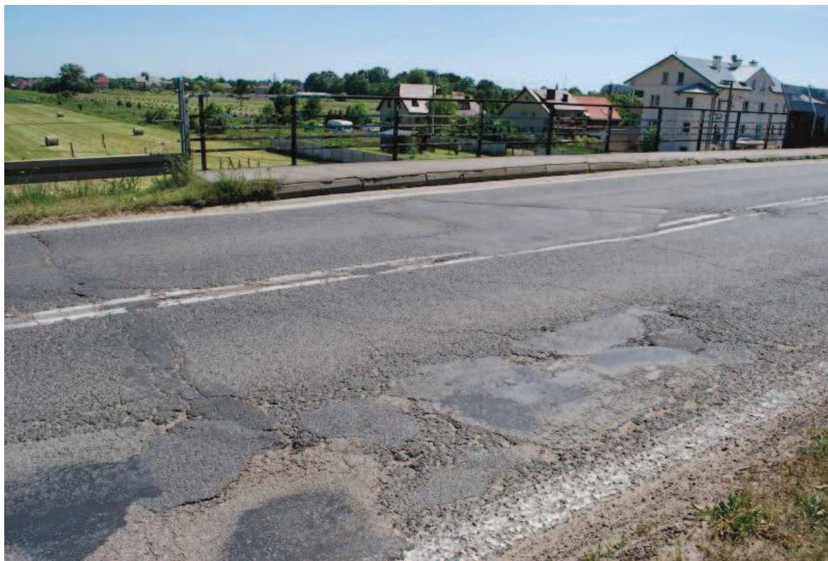
Fot. 17. Widok na nawierzchnię w strefie dylatacji północnej. Widoczne rysy, ubytki, zanieczyszczenia oraz deformacje asfaltu.
