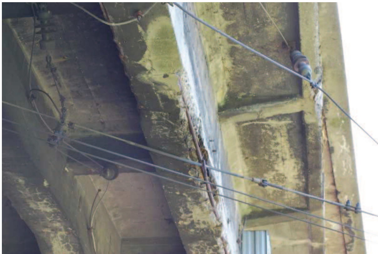
Fot. 11. Widok na belkę ramy zewnętrznej po stronie zachodniej. Widoczne ubytki, rysy, osady i zanieczyszczenia betonu oraz korozja stali zbrojeniowej.
