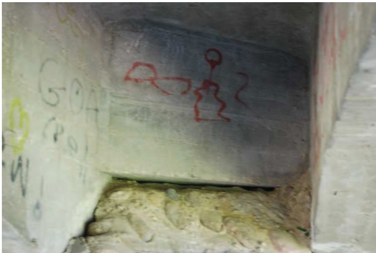
Fot. 15. Widok na poprzecnicę skrajną. Widoczne zanieczyszczenia grafitti.
