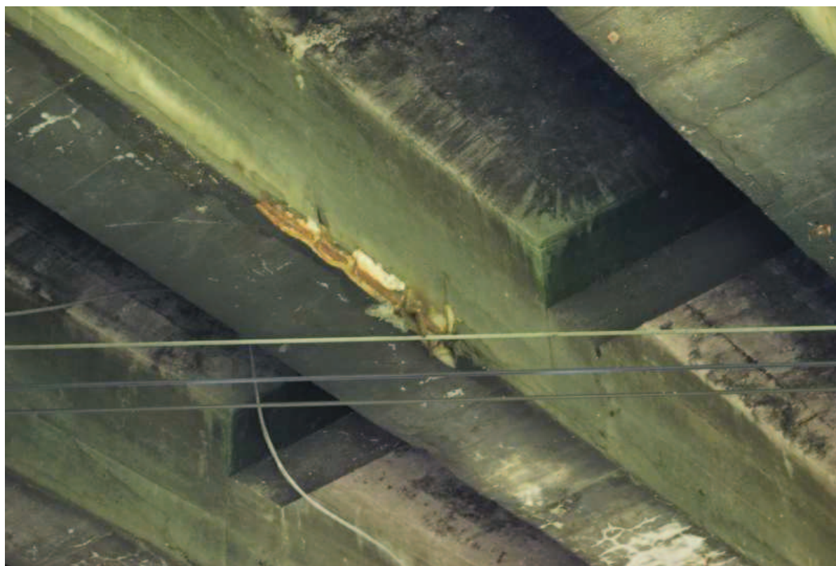
Fot. 12. Widok na belkę ramy wewnętrznej. Widoczne ubytki, rysy betonu i korozja stali zbrojeniowej belki oraz osady i zanieczyszczenia płyty pomostu.
