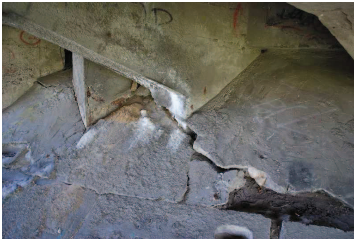
Fot. 16. Widok umocnioną skarpy zachodnią przy podporach skrajnych. Widoczne rysy, ubytki i przemieszczenia betonu spowodowane prawdopodobnie przemieszczeniem gruntu.
