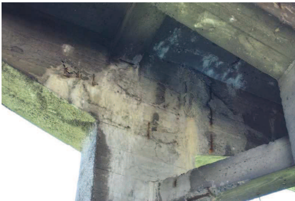
Fot. 10. Widok na górny odcinek południowej podpory pośredniej po stronie zachodniej. Widoczne rysy, ubytki betonu oraz osady i zacieki spowodowane przeciekami wody przez nieszczelną izolację pomostu.
