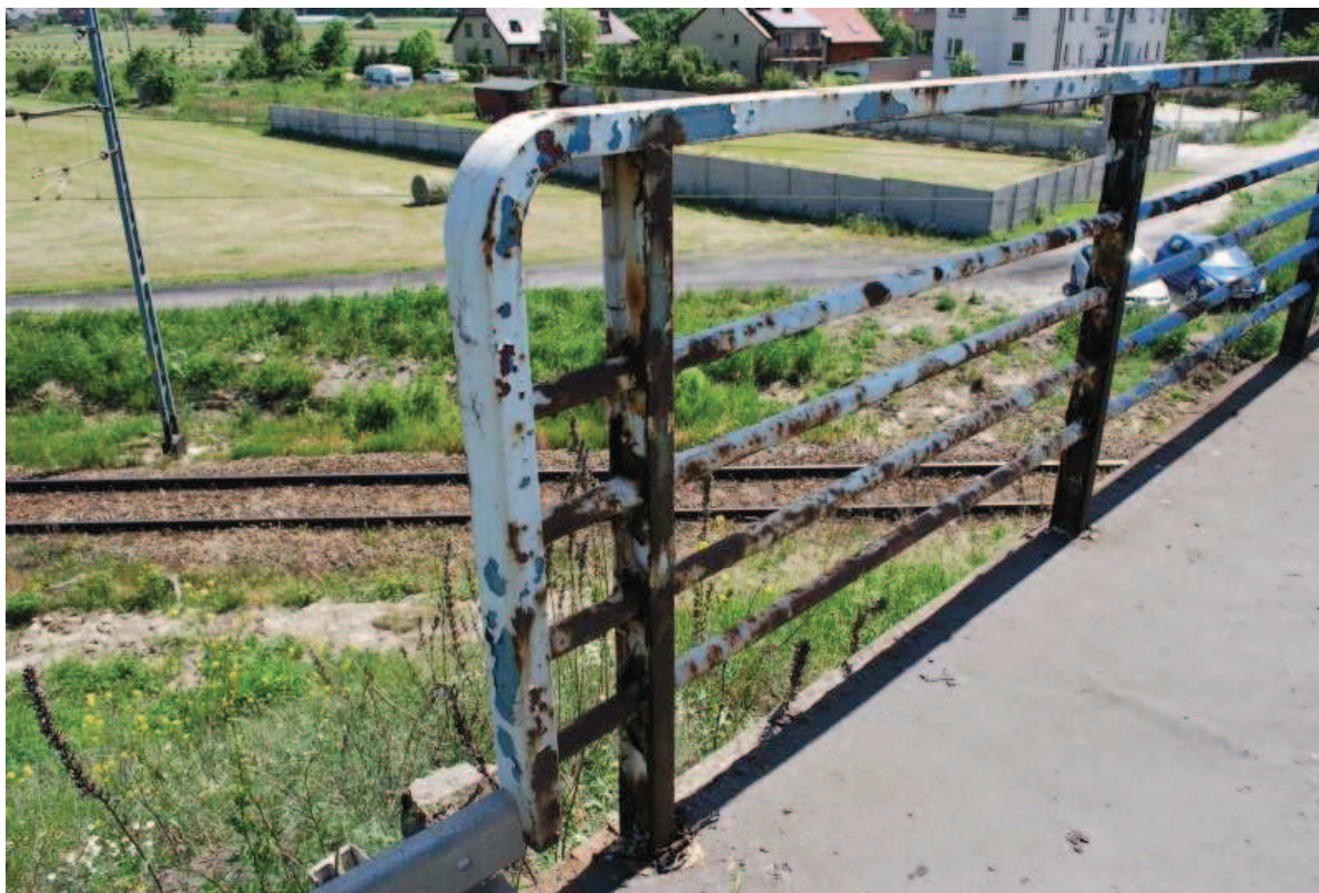
Fot. 19. Widok na balustradę wschodnią po stronie północnej. Widoczna intensywna korozja stali oraz ubytek zabezpieczenia antykorozyjnego elementów balustrady
